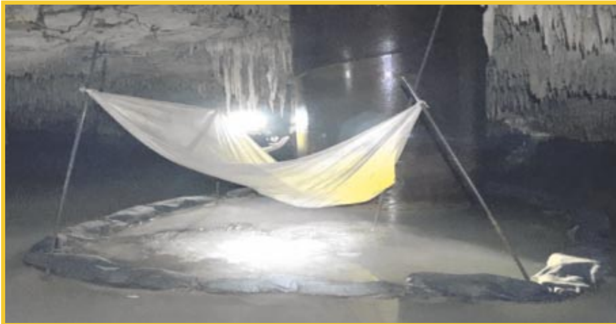
Ambientalistas denunciaron la colocación de “hamacas” para contener un escurrimiento de diésel en un pozo de agua ubicado bajo las obras del Tren Maya.
