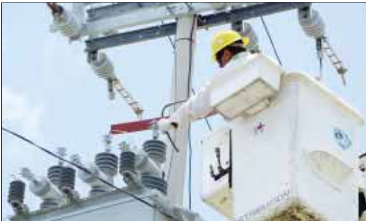
Las grúas que se utilizan para el cambio de transformador o reparación de interruptores, se encuentran en mal estado, y muchas veces la CFE recurre a la renta de particulares.
