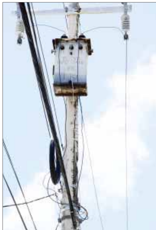
Este transformador ya se encuentra pasando aceite, como puede observarse; tiene más de 10 años que no recibe mantenimiento.
