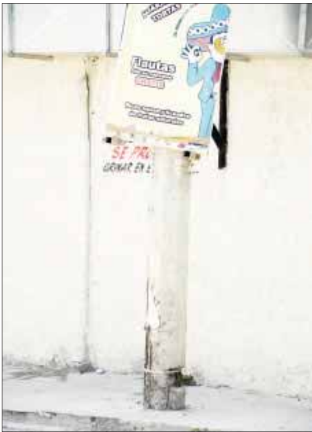
Este poste, ubicado en avenida Tulum, se encuentra debilitado de su base y no tardará en caerse.
