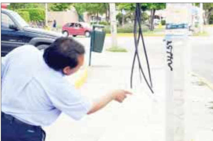
Uno de los transeúntes del centro de Cancún, señala el cable cortado con energía eléctrica, que momentos antes le dio "toques".
