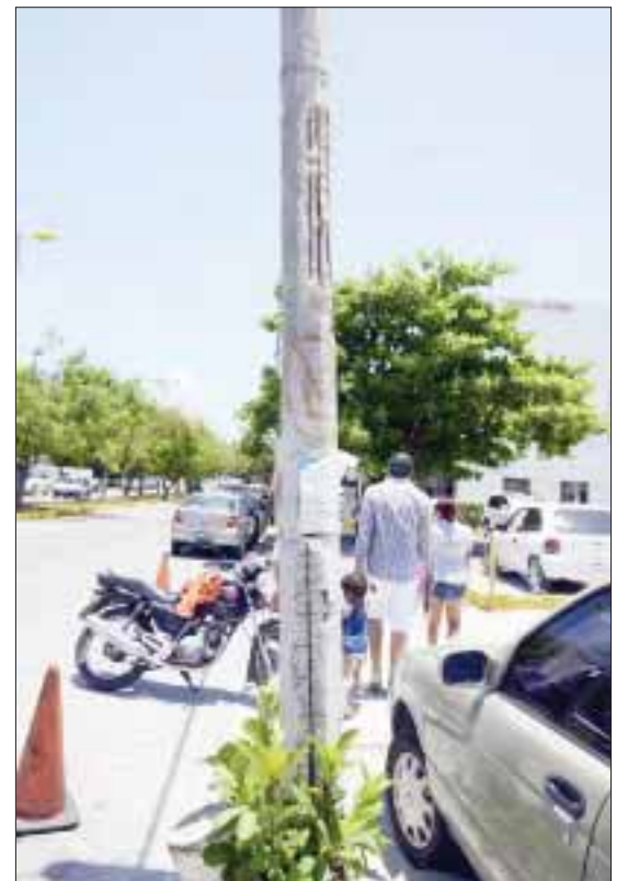
Sobre avenida Nader, detrás del palacio municipal, se puede observar "esta belleza" de poste que sostiene los cables conductores.
