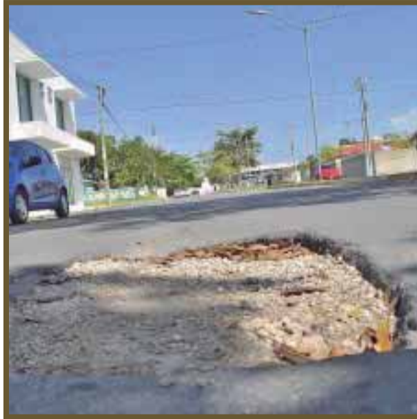
Ciudadanos tapan con piedras y escombros los baches de su avenida.
