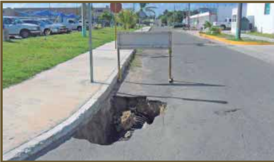
La falta de compactación de los trabajos de drenaje provoca que el agua arrastre el material pétreo.
