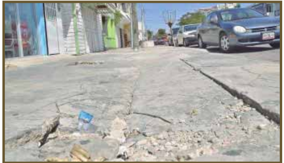
En mal estado se encuentran las banquetas del centro de OPB.
