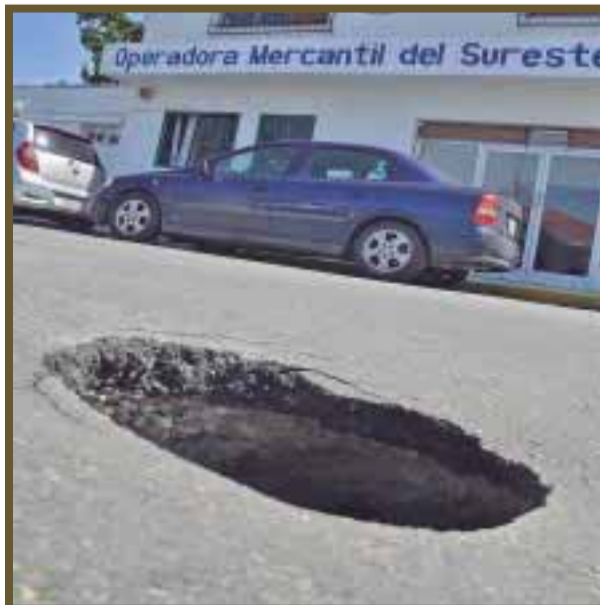
La profundidad de los hundimientos llega a ser de hasta dos metros.
