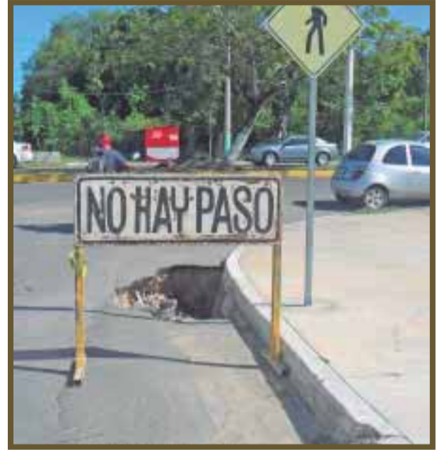
Señalamientos contradictorios, paso peatonal y "no hay paso".
