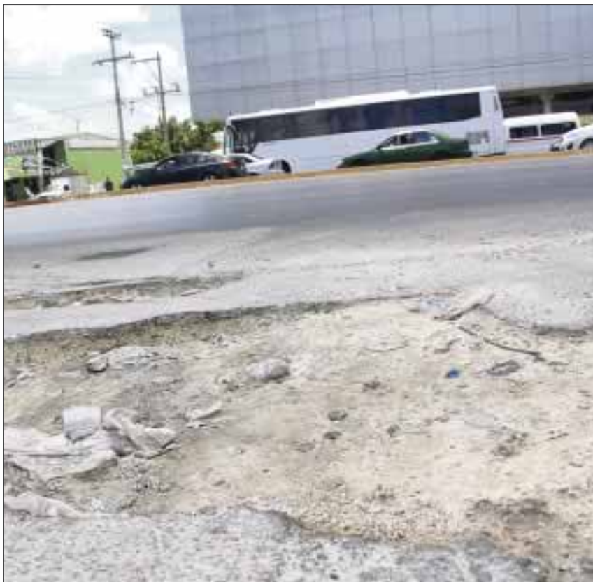
Esta calle que lleva casi un año destrozada por los baches, fue reportada por vecinos y comerciantes de la avenida López Portillo.
