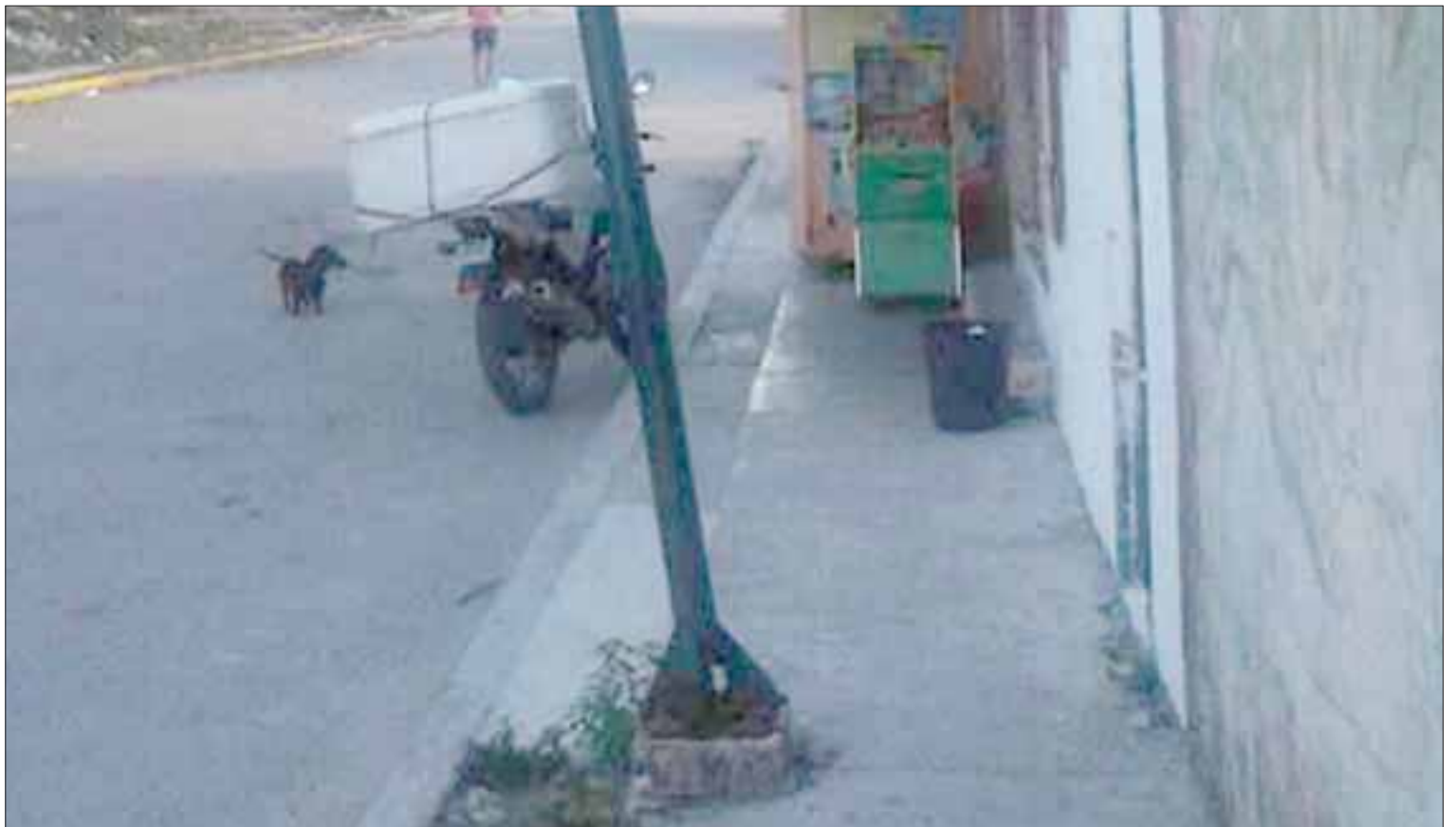
Con estas fotos enviadas por vecinos de Tierra Maya, se ilustra el mal estado en el que se encuentra un poste en su fraccionamiento.
