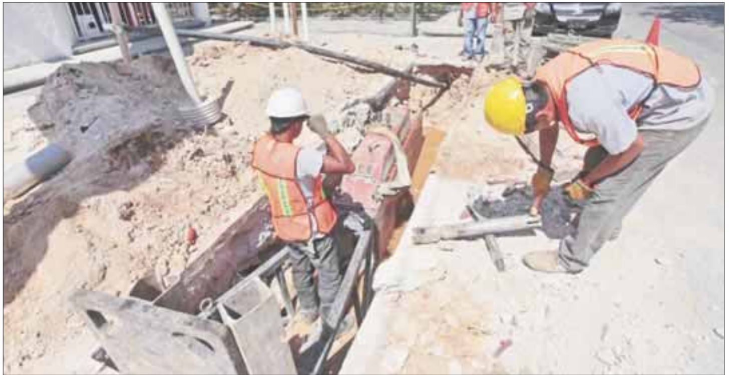
Los trabajos iniciados en noviembre para rehabilitar la zona centro de la ciudad, dejará sin agua a varias zonas de la ciudad durante el transcurso del día.
