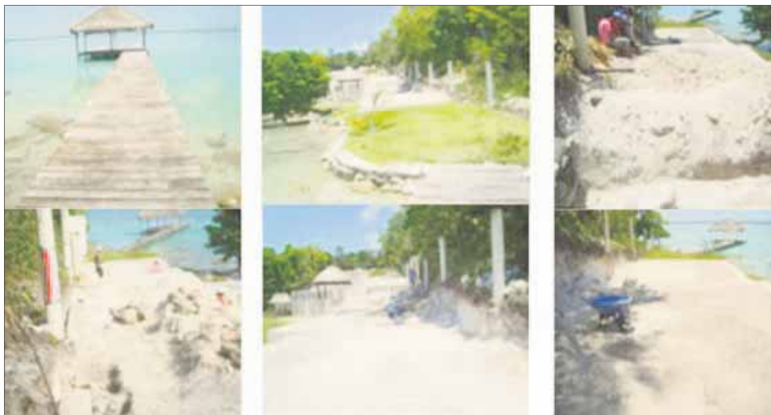
La Profepa impuso la clausura total temporal de las actividades realizadas para la construcción de una casa de descanso, en un predio ubicado en el Camino Costero Aarón Merino Fernández.
