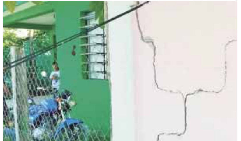
Afirman vecinos que durante los trabajos fueron apareciendo grietas, tanto en paredes como pisos y banquetas.
