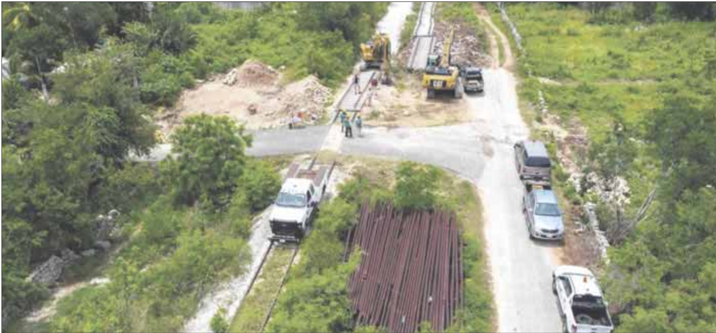
El arranque de los trabajos físicos del Tren Maya en Quintana Roo está programado para el primer trimestre de 2021.
