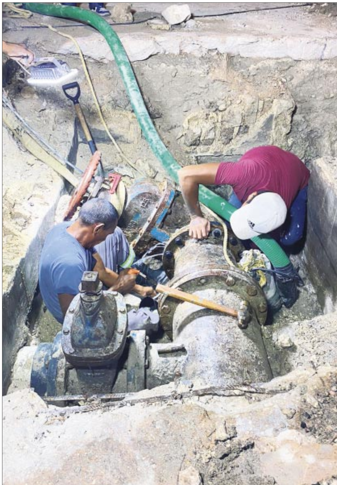
Trabajadores de CAPA avanzan en la tercera etapa de la sustitución del colector de aguas residuales de la avenida “Rafael E. Melgar”.
