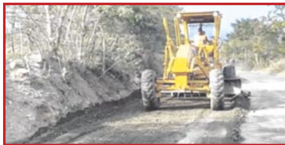
Hoteleros del sur piden que se reparen las carreteras que han sido dañadas con las obras del Tren Maya, para no afectar el turismo.
