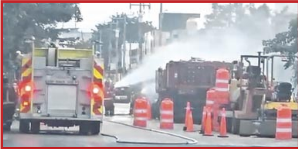
Una fuga de gas de la máquina de repavimentación conocida como “Dragón” provocó alarma en la avenida Nichupté, cerca de la Guarnición Militar.
