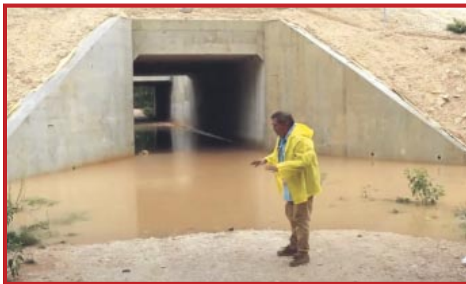
Denuncian la formación de un presunto socavón en el Tramo 4 del Tren Maya.
