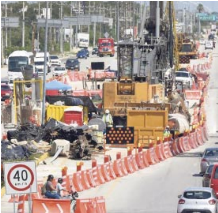
La Sedena reparará los daños causados por las obras del Tren Maya en la Carretera 307.
